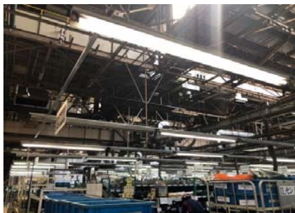
従来の照明設置状況
