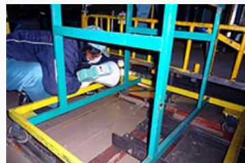
巡查气体泄漏
