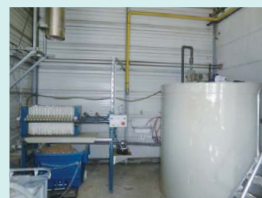
废水处理设备
