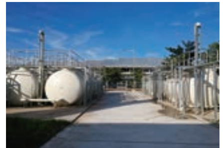
净化槽 在未完善下水道的地区进行排水处理。
